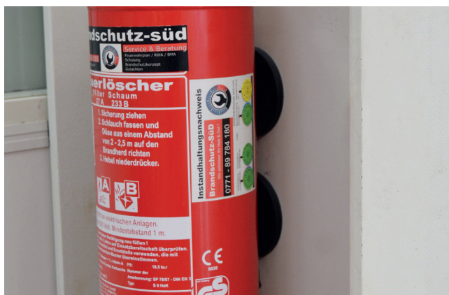
Halterung von Feuerlöschern etc. direkt am Stahlträger
